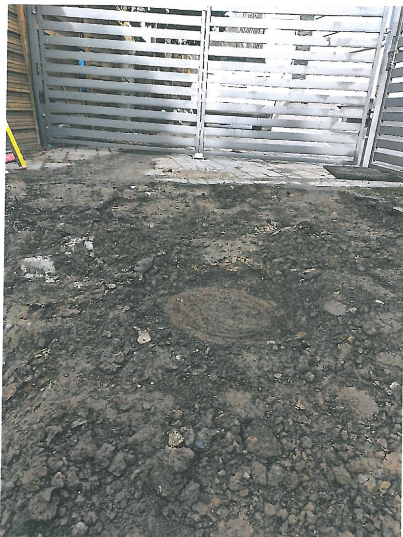
[Fot. 6 Studnia kanalizacji sanitarnej przykryta materiałem obcym wymagająca regulacji wysokościowej przez ZWiUK]
